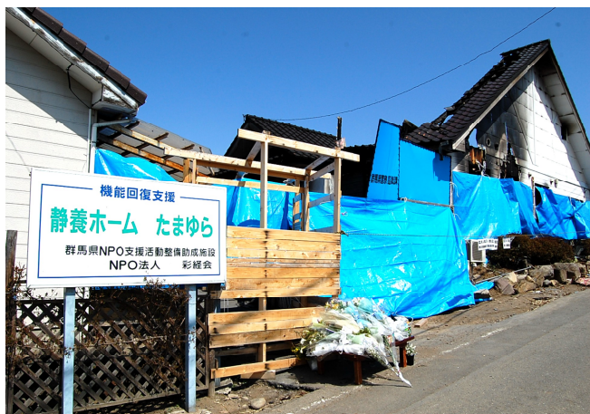
火災にあった静養ホームたまゆら
